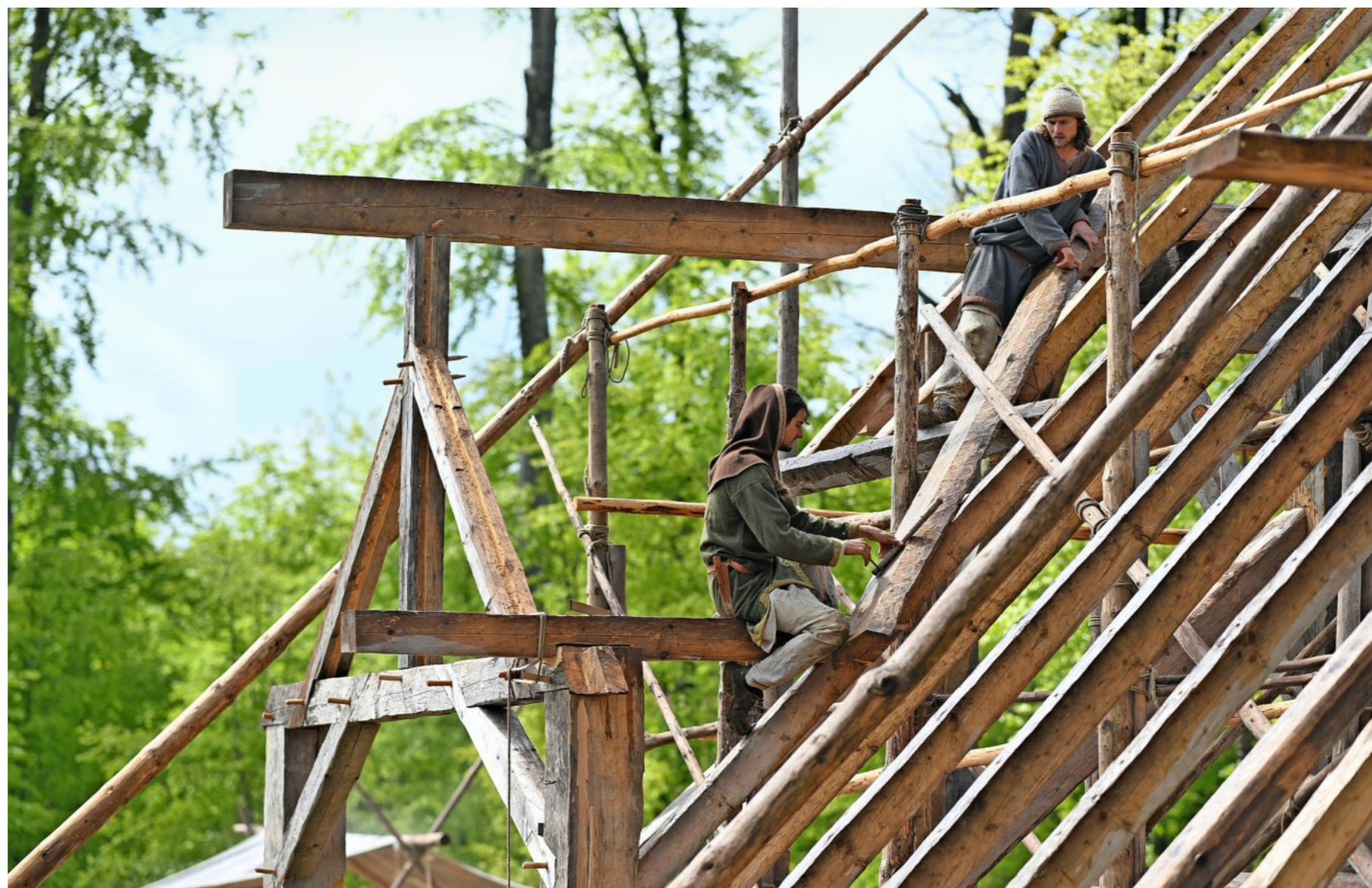
Altbewährtes für heute: Im schwäbischen Meßkirch arbeiten Zimmerleute mit gut abgelagertem Holz und traditionellen Techniken an einer mittelalterlichen Klosterstadt Foto dpa
